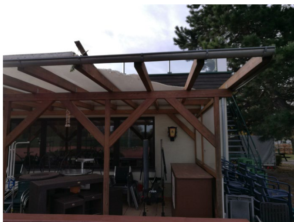
Beschädigte Terrassenüberdachung Herbst 2018
