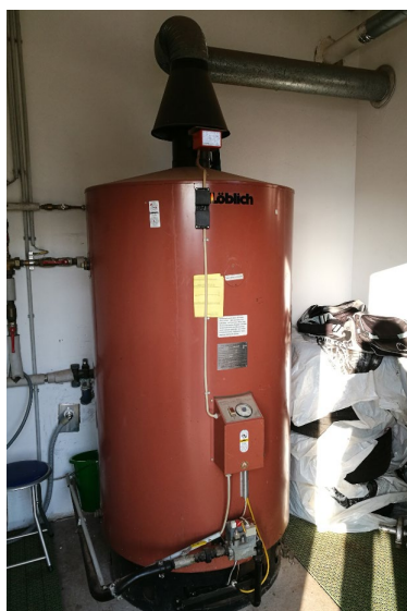
Alter WW-Speicher, Bj. 1989
