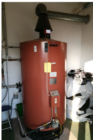
Alter WW-Speicher, Bj. 1989
