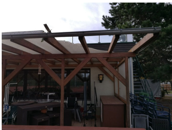
Beschädigte Terrassenüberdachung Herbst 2018
